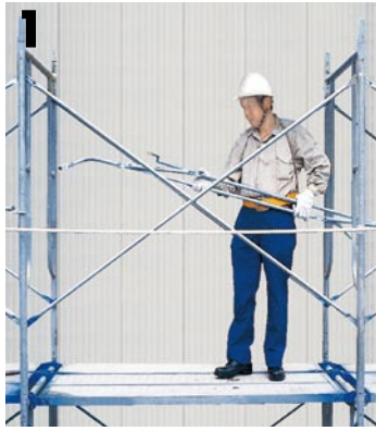
折り畳み二段手摺が閉じた状態
